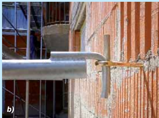
Fot. 1. Rusztowanie zakotwione prawidłowo
