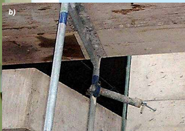
Fot. 2. Rusztowania zakotwione nieprawidłowo
