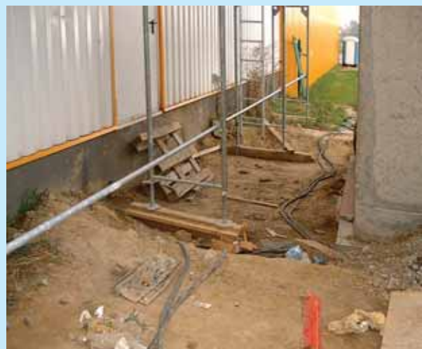
Fot. 3. Posadowienie nieprawidłowe
