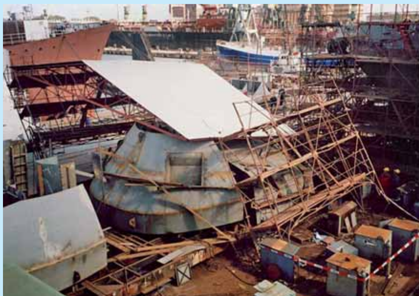
Fot. 9. Efekt katastrofy budowlanej na terenie stoczni w Gdyni
