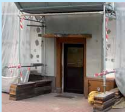
Fot. 2b. Posadowienie nieprawidłowe
