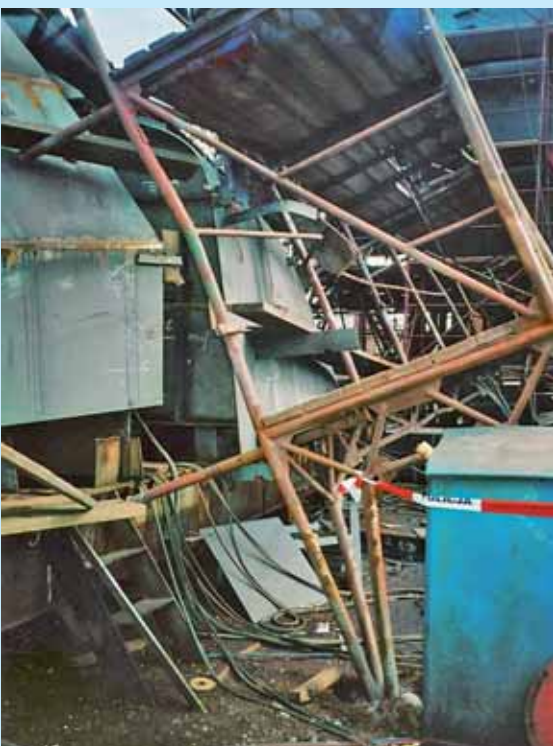
Fot. 8. Wadliwe posadowienie rusztowania na terenie stoczni w Gdyni
