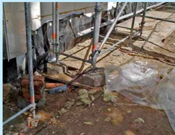
Fot. 4. Posadowienie nieprawidłowe
