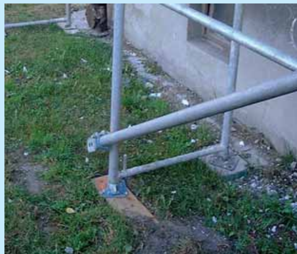
Fot. 5. Posadowienie nieprawidłowe
