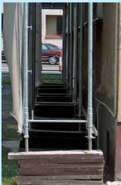
Fot. 2a. Posadowienie nieprawidłowe
