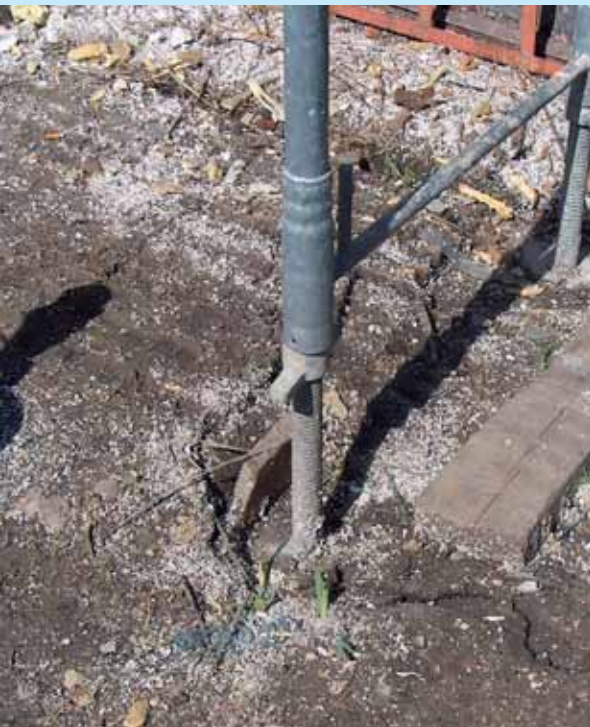
Fot. 6. Posadowienie nieprawidłowe
