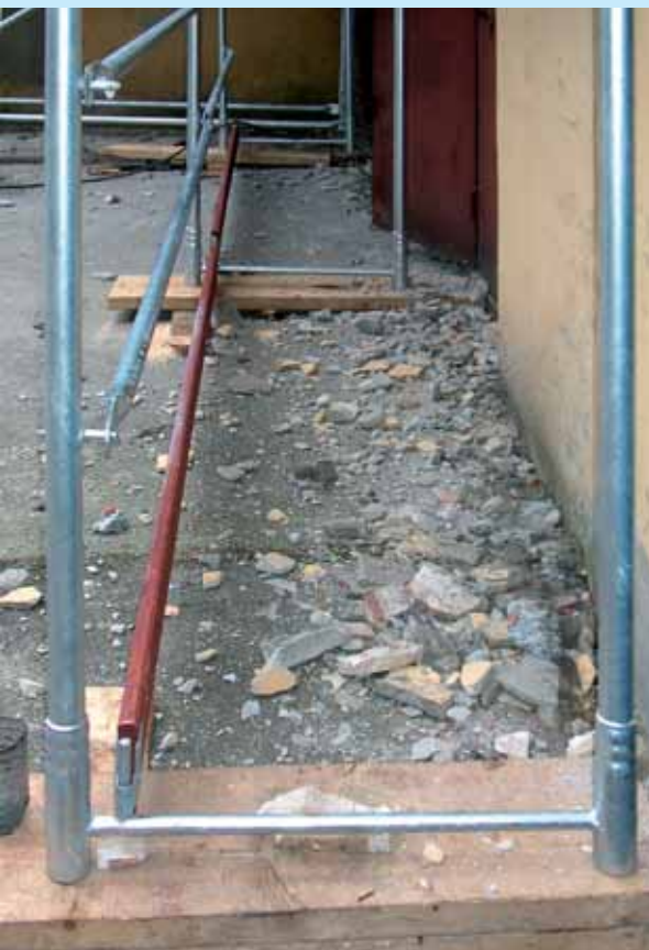
Fot. 7. Posadowienie nieprawidłowe
